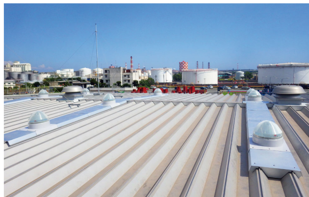
屋根に設置された採光ドーム
