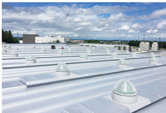
屋根に設置された採光ドーム。
