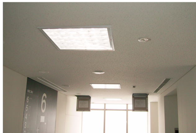
明るく輝いているのが最上階に設置された「太陽光照明システム」
