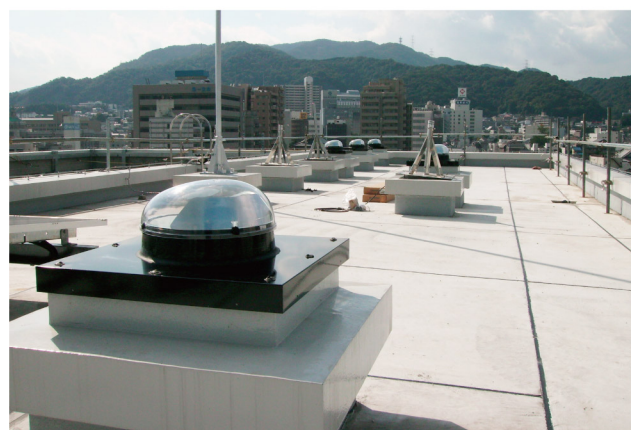
屋上に設置された採光ドーム
