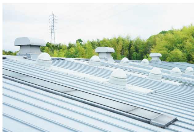
屋根に設置された8台の採光ドーム
